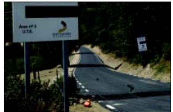
... Y DESPUÉS. Carretera de El Cardoso después de su reforma y ensanche.
