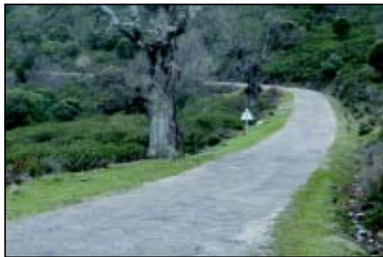
ANTES... La carretera de acceso a El Cardoso, antes de su arreglo.
